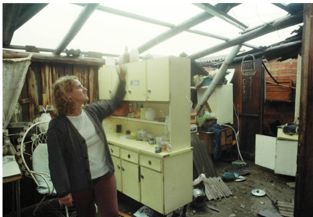
Figura 25: Estragos em residência no bairro Paraíso, no município de Criciúma - SC.
