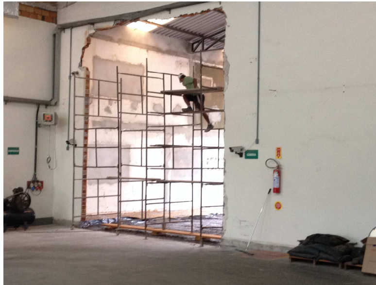
Figura 1 – Andaime instalado sobre superfície irregular
