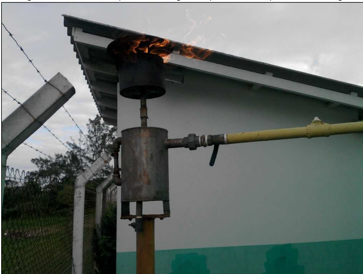
Figura 6 – Sistema de queima de biogás desprovida de dispositivo corta-fogo
