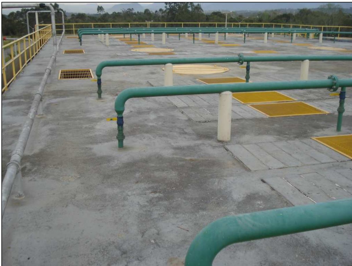
Figura 7 – Detalhe das tubulações, pisos e grades de proteção
