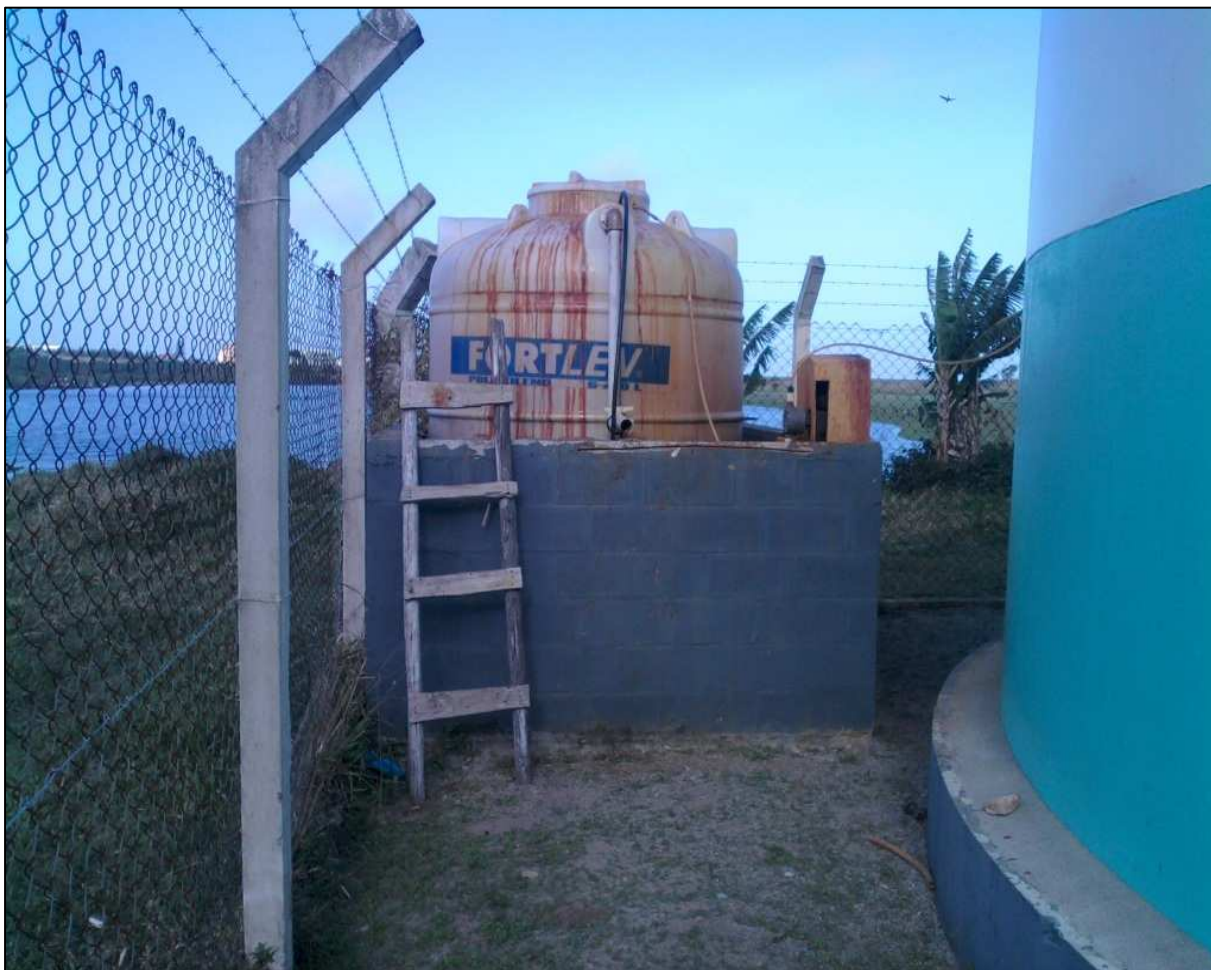
Figura 3 – Tanque de preparo de cloreto férrico
