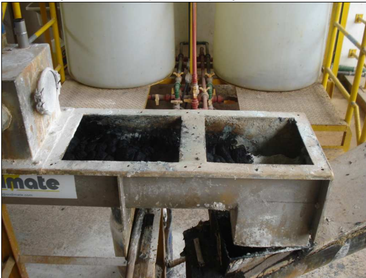
Figura 2 – Rosca transportadora desprotegida – ETE Criciúma
