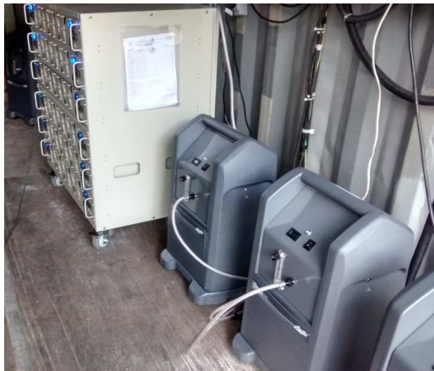
Figura 11 - Posicionamento do gerador e do concentrador de ozônio dentro do container .
