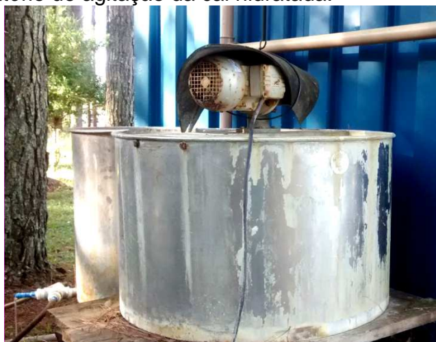
Figura 14 - Reservatório de agitação da cal hidratada.
