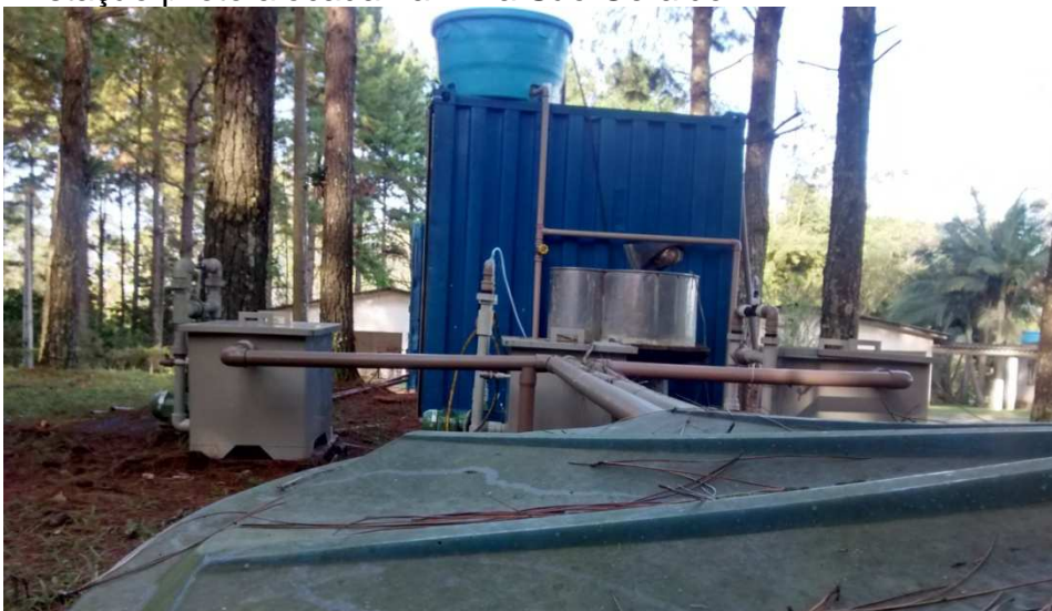
Figura 7 - Estação piloto alocada na Mina São Geraldo.
