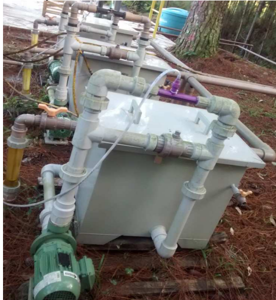
Figura 12 - Reatores com tubos de Venturi acoplados nas estruturas, representados nas cores roxa e preta.
