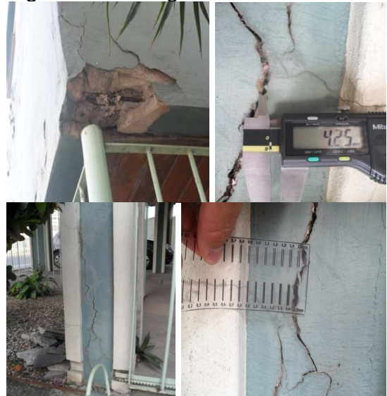
Figura 2: Patologias nas estruturas.
