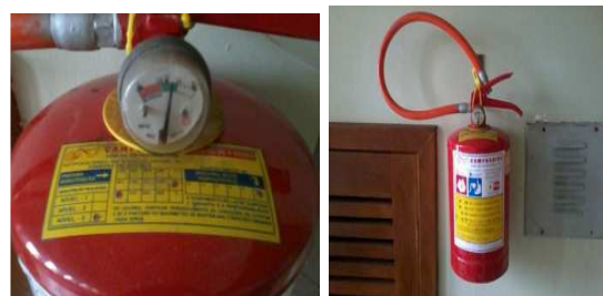
Figura 4: Patologias nos extintores.
