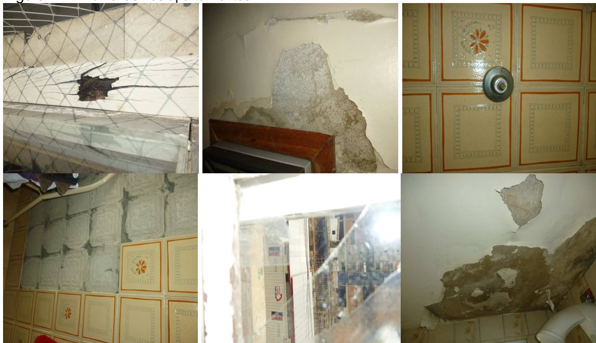
Figura 12: Anomalias nos apartamentos
