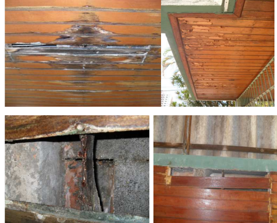
Figura 7: Patologias nos forros.
