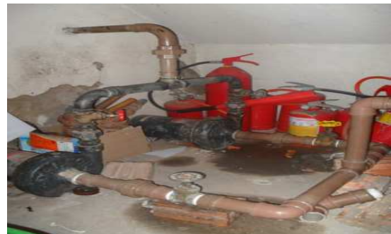
Figura6:Patologia nas bombas hidráulica.
