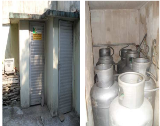
Figura 11: Patologia na central de gás
