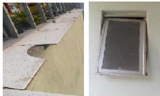
Figura 8: Patologias nos esquadrias.
