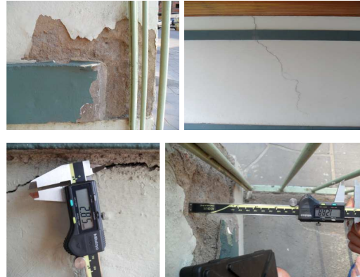
Figura 5: Patologia nas alvenarias.
