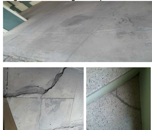
Figura 10: Patologia nos pisos
