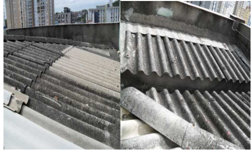
Figura 9: Patologias na cobertura.
