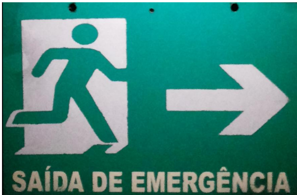
Figura 10: Placa de Sinalização de emergência Fixada a 0,50m e a 1,80m do piso(Lapa) na lateral esquerda da galeria no sentido subsolo/superfície.
