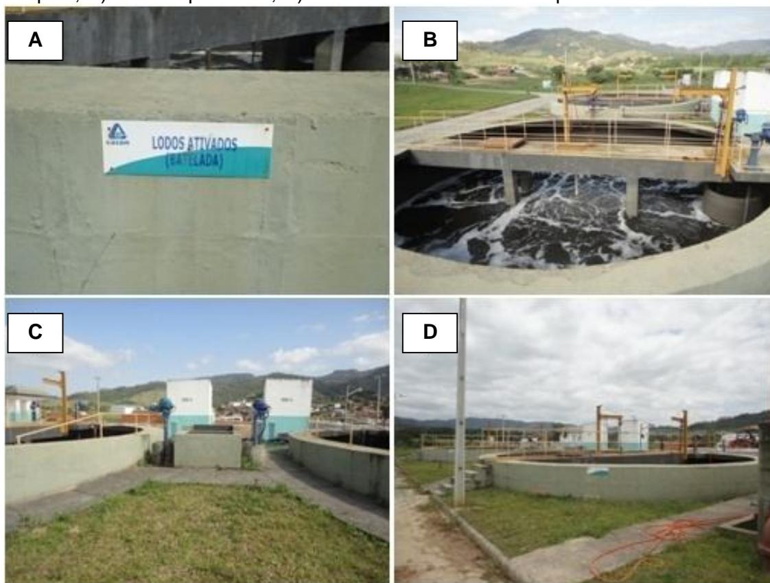
Figura 6 - Sistema de lodos ativados, onde: A) Identificação; B) Vista dos dois tanques; C) Caixa separadora; D) Vista lateral de um dos tanques
