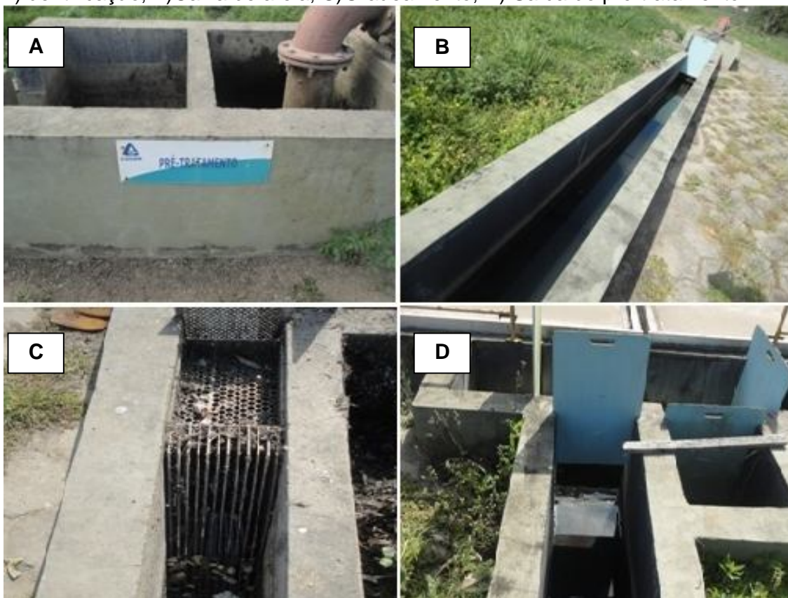
Figura 4 - Componentes do pré-tratamento da ETE de Gravatal, onde: A) Identificação; B) Caixa de areia; C) Gradeamento; D) Saída do pré-tratamento
