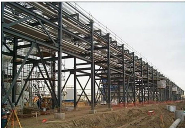
Gambar 1. Konstruksi Baja Pipe Rack dengan Pipa
