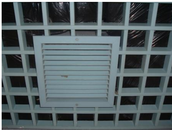
Figura 9 – Forro em lã de rocha envolta em sacos plásticos preto sobre estrutura de grades em madeira utilizada no Aeroporto Internacional dos Guararapes – Recife/PE
