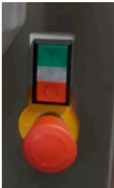
Figura 41 - Botões de ligar e desligar + botão de emergência (Fonte: próprio autor)
