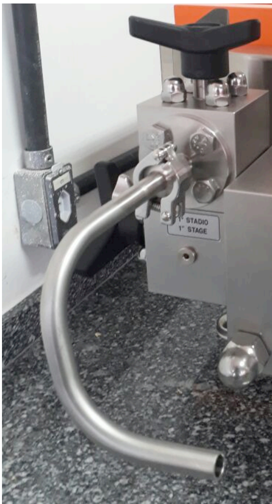
Figura 44 - Tubulação de saída de produto (Fonte: próprio autor)
