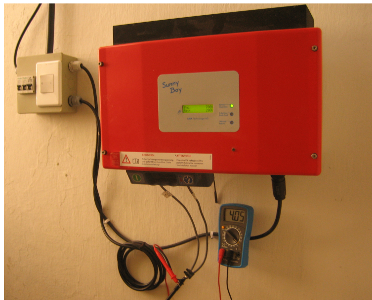
Figura 66. Inversor DC-AC SunnyBoy 1100 instalado na estação climatológica do CEAR. Fonte: Autoria própria.
