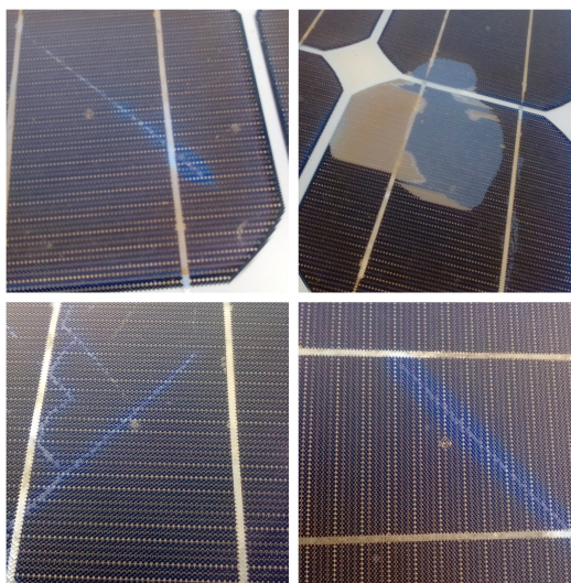
Figura 73. Algumas das células quebradas em alguns dos módulos instalados. Fonte: Autoria Própria.
