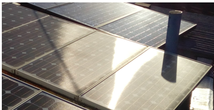
Figura 87. Sombreamento sobre o arranjo de módulos fotovoltaicos que aparece depois das 15:30 horas. O sombreamento reduz a corrente de saída do sistema. Fonte: Aatoria própria.
