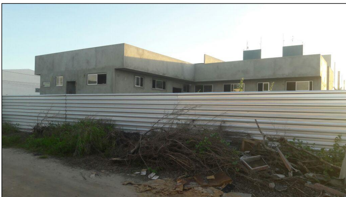
FIGURA 5 – UNIDADE DE SAÚDE DO LOTEAMENTO, EM CONSTRUÇÃO HÁ 4 ANOS.
