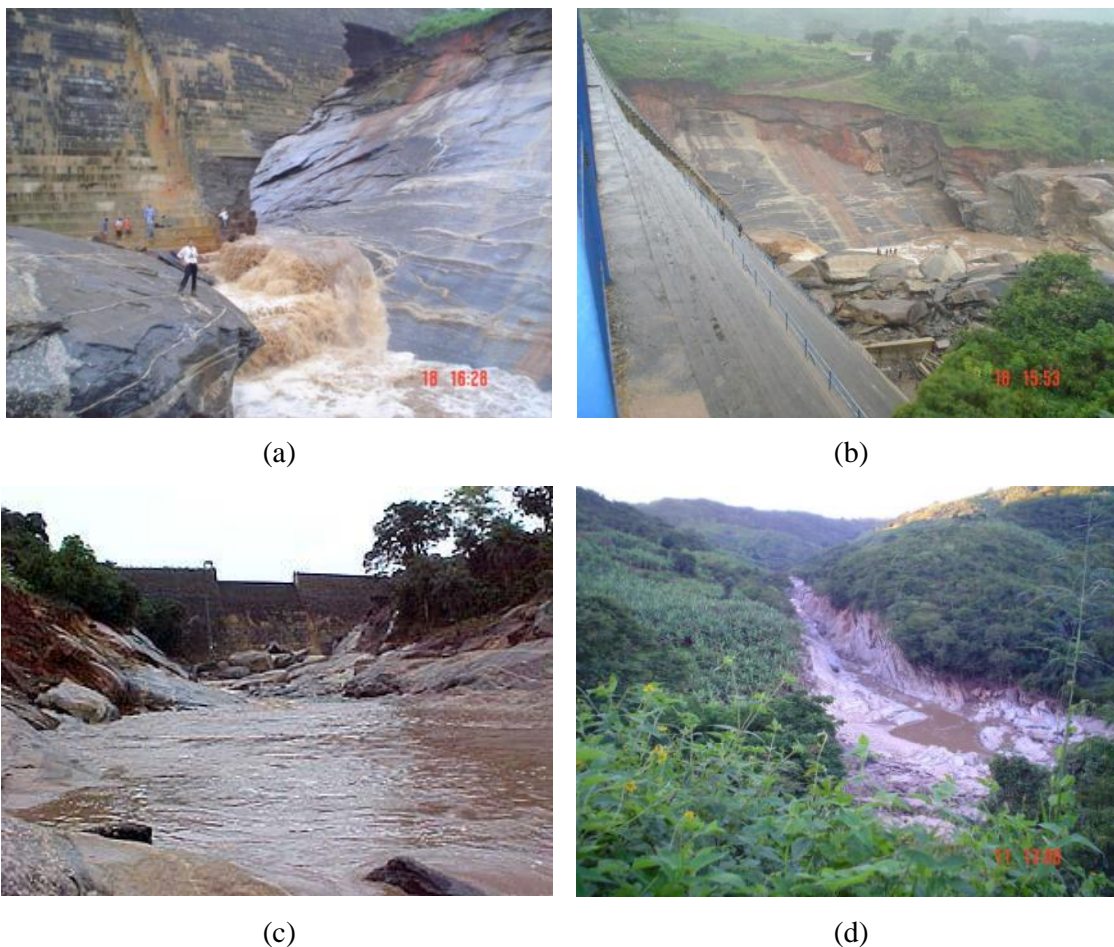
Figura 5.6 - (a) Vista a jusante da parte da barragem rompida. (b) Vista da parede rompida pela força da água. (c) Foto a jusante da barragem. (d) Trecho destruído em virtude da força da água levando vegetação e rochas (junho de 2004).
