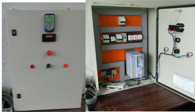
Figura 4.3 - Quadro de comando.
