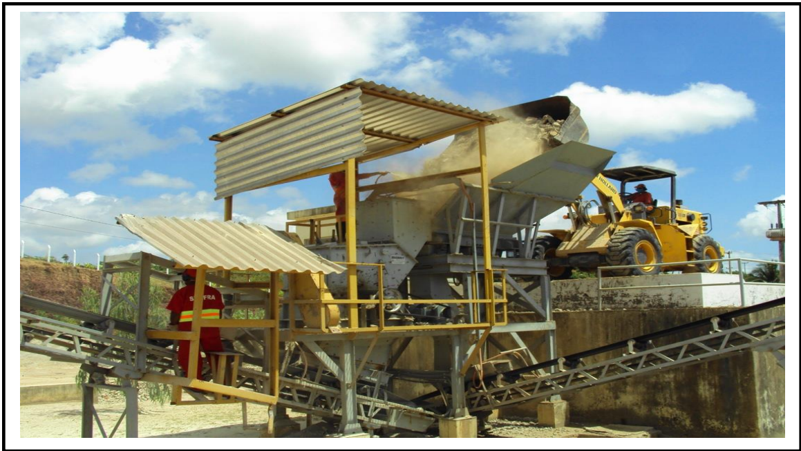
Figura 2.13: Britador de RCC (interior da USIBEN)
