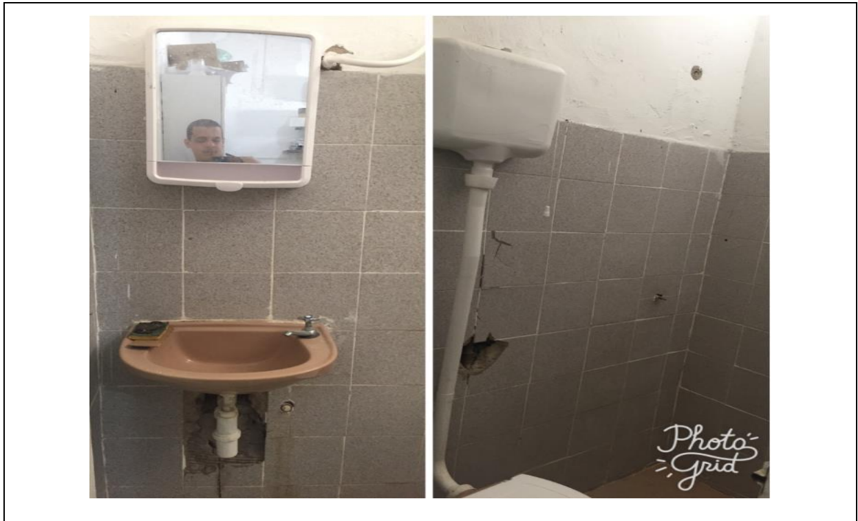
Figura 18 - Visualização do layout , banheiro inadequado na área de produção - Império Doces
