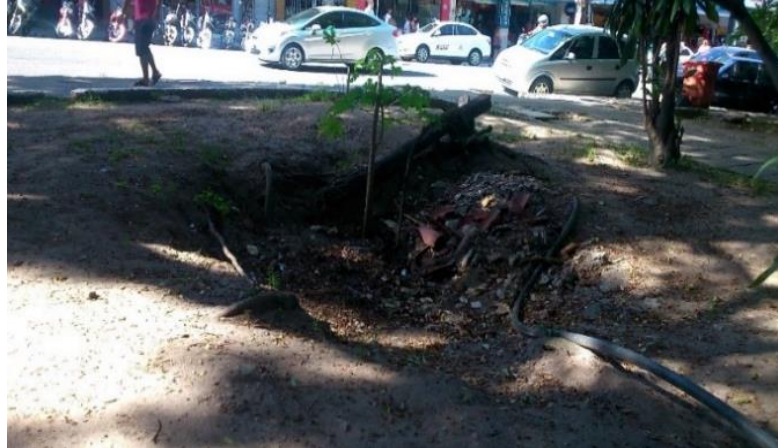
Figura 9 – Ravinamento próximo ao quiosque
