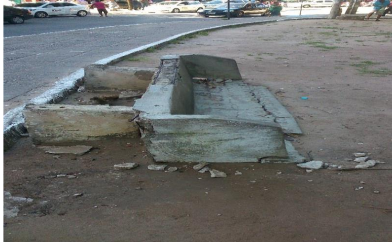
Figura 11 – Banco do Parque totalmente destruído
