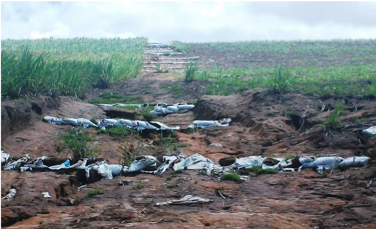
Foto 6 - Colocação de sacos de areia no intuito de conter a erosão na vertente. Essa situação é percebida ao longo de toda a estrada que liga a BR 101 ao Distrito de Forte Velho, Santa Rita – PB. Fonte: avervo do autor. Data 05/06/2013.
