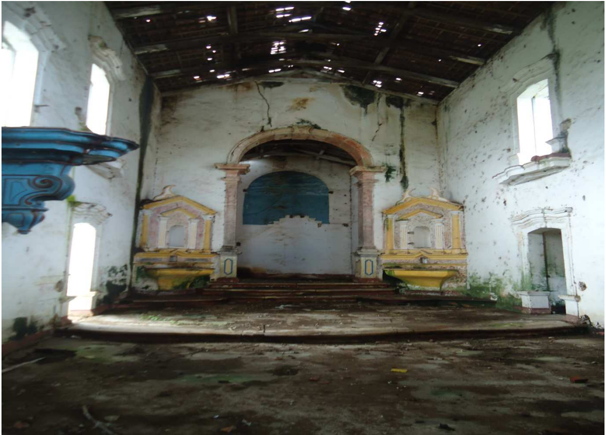
Foto 3 – Visão interior da Capela Santana. Percebe-se o estado de abandono em que se encontra esse monumento histórico. Fonte: Acervo do autor. (Data: 12/07/2013).
