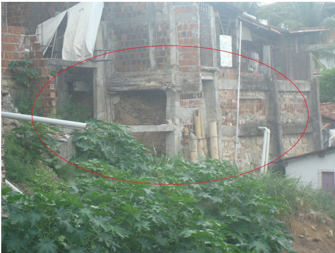
Foto 9 Residência com piso em subsidência. Fonte: GARCIA 07-03-2013
