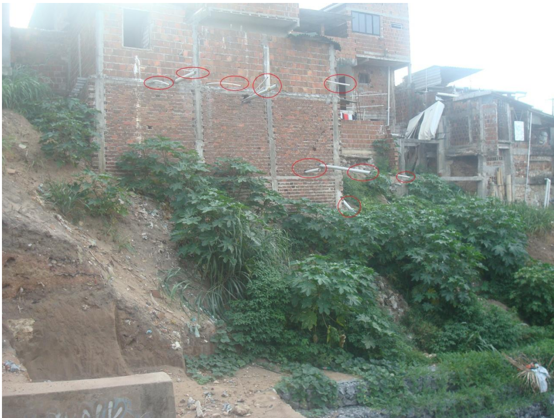
Foto 8 Lançamento de efluentes domésticos na encosta. Fonte: GARCIA 07-03-2013
