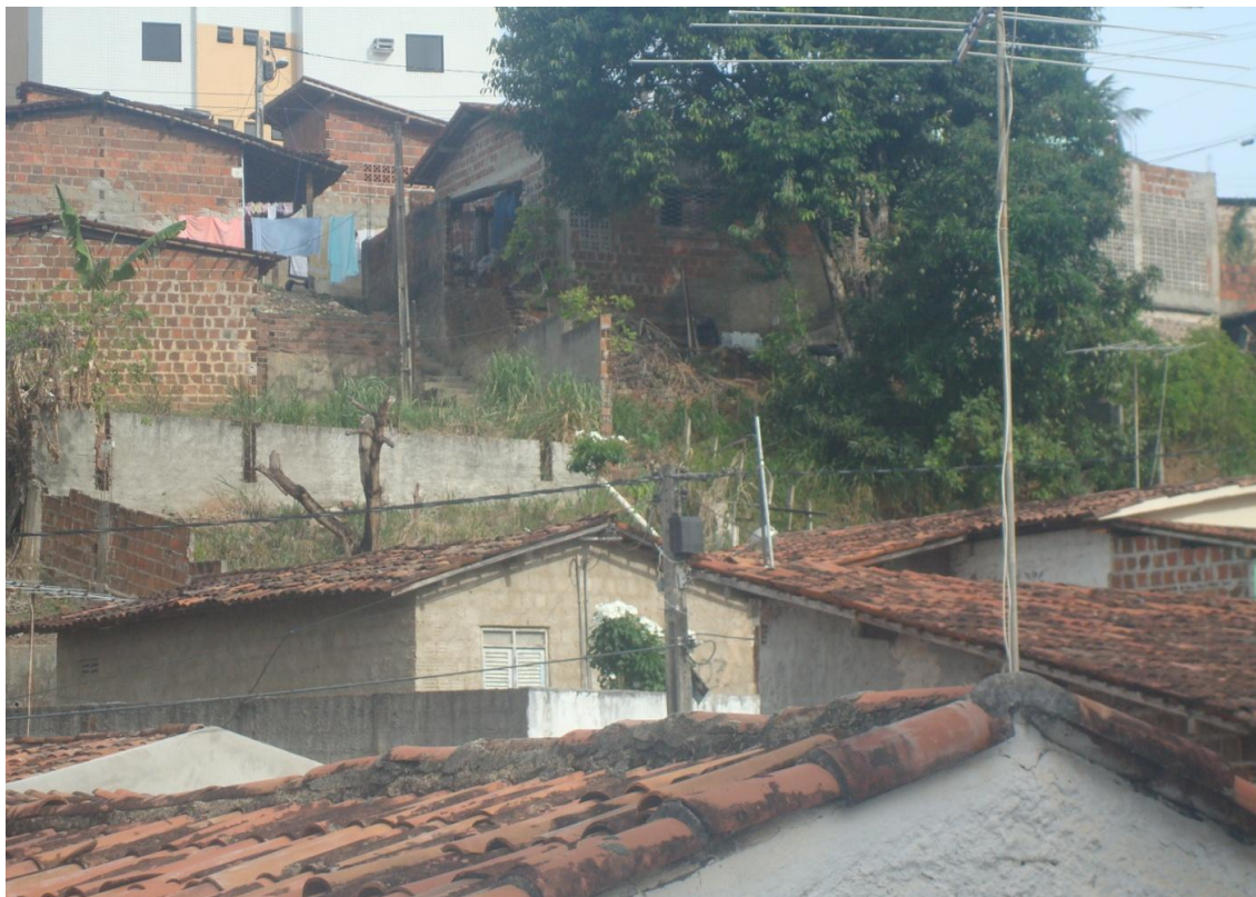
Foto 4 Árvores de grande porte no talude. Fonte: GARCIA 07-03-2013
