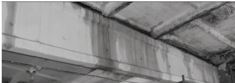
Рис.1. Сліди замочування двосхилої балки покриття
