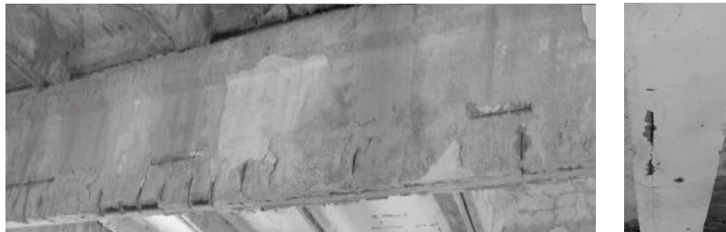
Рис. 2. Руйнування захисного шару бетону балок покриття, тріщини вздовж арматурних стержнів, оголення та корозія арматури
