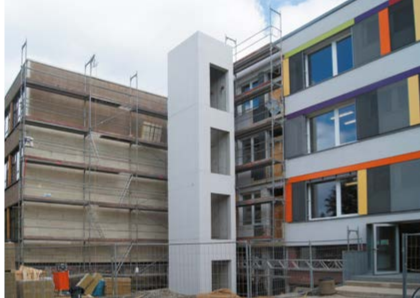
^ Рис. 11. Горбиц. Реконструкция здания с применением современных материалов, утеплением, заменой окон и установкой лифтовой шахты (реконструированная часть и еще не тронутый блок). Фото Е. Гладковой, 2016
