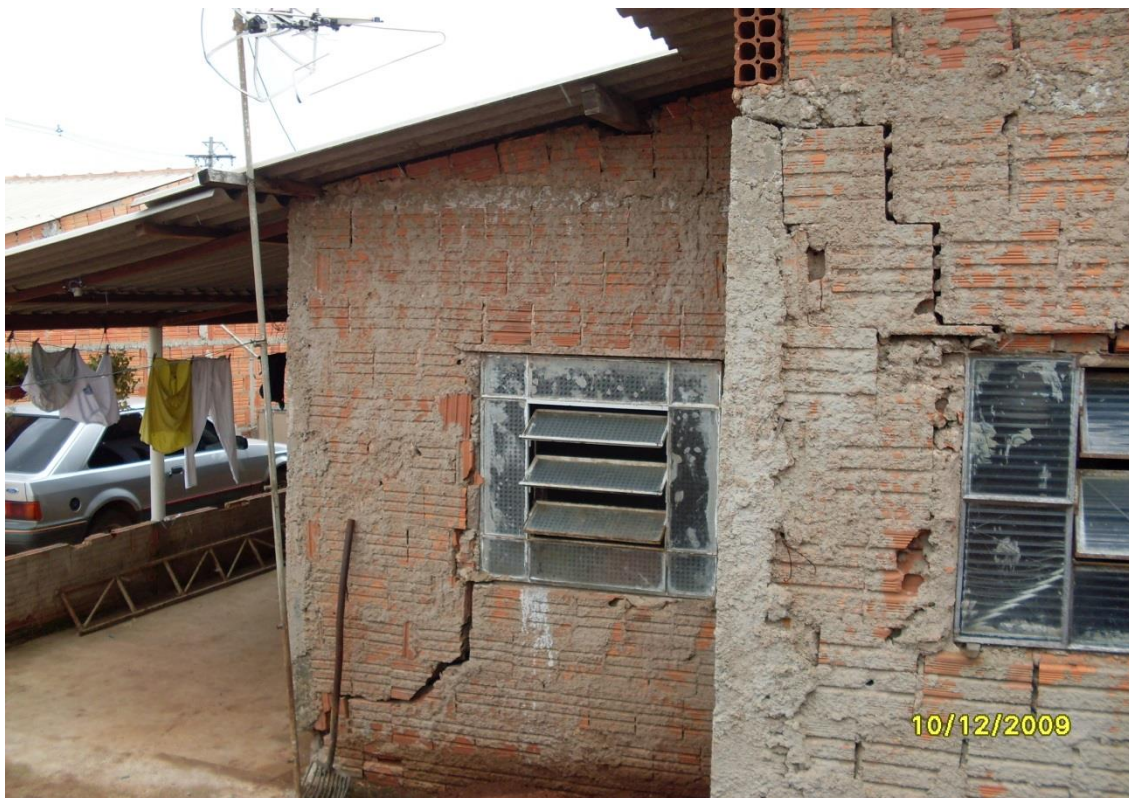
FIGURA 28 - EDIFICAÇÕES EM SITUAÇÃO DE RISCO
