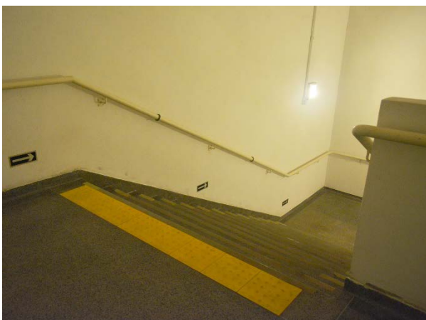
Figura 108: Piso tátil de alerta e sinalização de degrau na escada de emergência da nova torre
