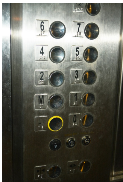
Figura 100: Painel interno do elevador com sinalização em Braille
