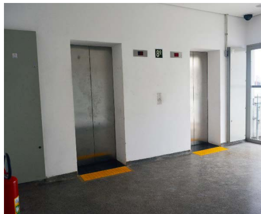
Figura 98: Elevadores de passageiro na nova torre
