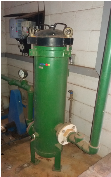
(a) filtro de água;
