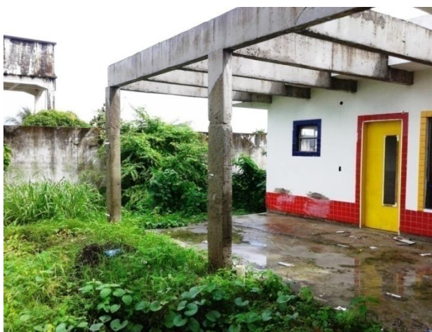
O abrigo definitivo acabou sendo uma obra inacabada da SEMED, cuja inauguração forçada já teria sido vetada pelos sindicalistas da educação por falta de estrutura adequada de funcionamento.
