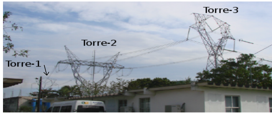
Figura 2.8: Torres reais no ambiente de testes onde são realizados os experimentos com arcos elétricos.
