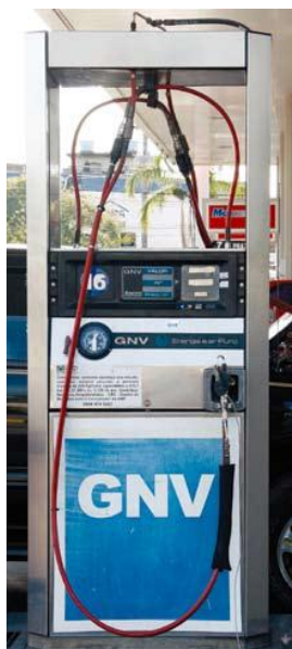
Figura 2.11- Dispenser para abastecimento de GNV
