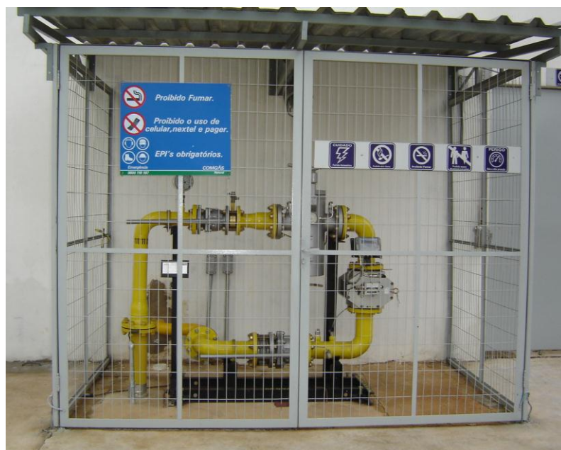
Figura 2.8- Estação de medição e totalização de um posto de abastecimento de GNV
