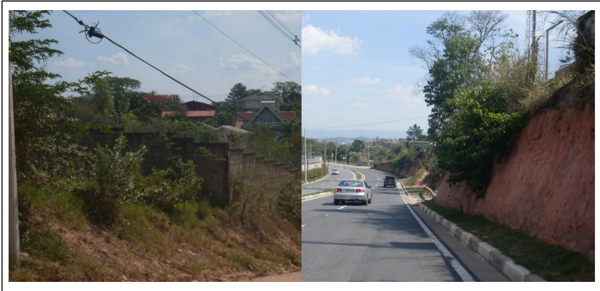
FIGURA 3.66. Regiões com processos incipientes de erosão, fundos do loteamento Vista Alegre. Fonte: Fotografia da autora, novembro de 2011.
