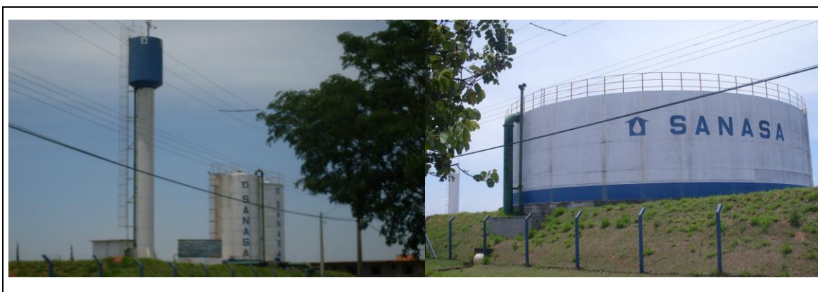
FIGURA. 3.27. Centro de Reservação Norte, sistema de abastecimento PUCC/Santa Teresinha- SANASA, localizada na área Alphaville. Fonte: Fotografias da autora, novembro 2011.
