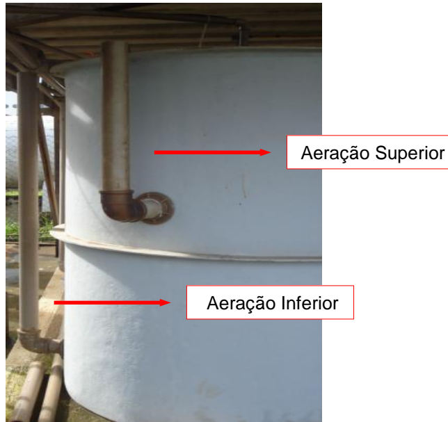
Figura 4.10: Vista geral do sistema de aeração inferior e superior dos filtros de areia.
