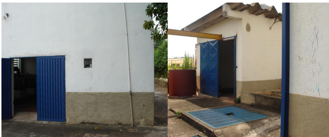
Figura 7.104: Vista externa de Estação Elevatória Jardim Tamoio (Arquivo Pessoal)
