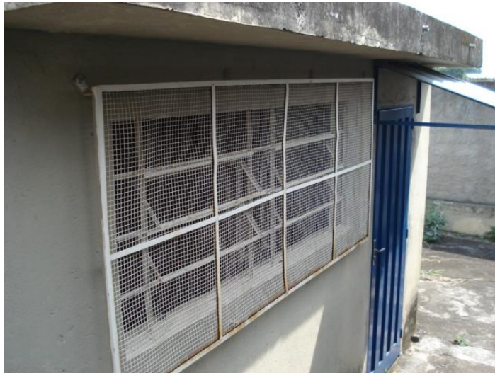
Figura 7.10: Vista externa de Estação Elevatória Jardim Itália (Arquivo Pessoal)
