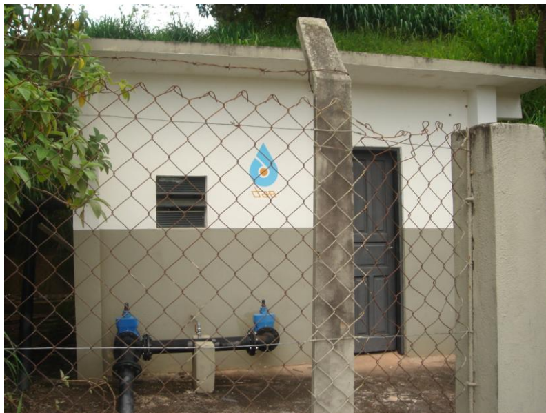
Figura 7.35: Vista externa de Estação Elevatória Copacabana (Arquivo Pessoal)
