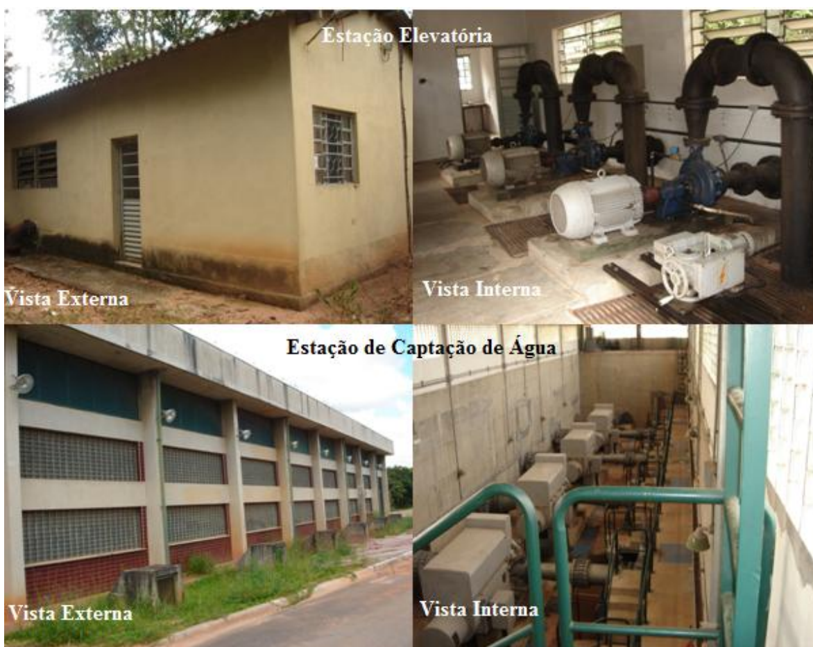
Figura 5.6: Vistas interna e externa de uma estação elevatória e de uma estação de captação de água
