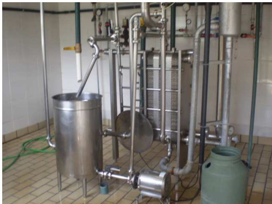
Figura 12. Trocador de calor a placas.
