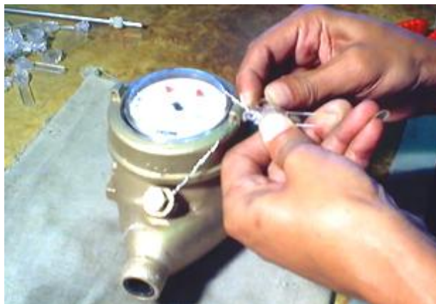
Figura 4.32: Lacração de hidrômetro com fio trançado de aço
