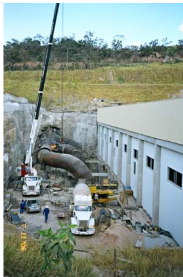
(5.6) Condutos de adução de água para as turbinas da PCH Mosquitão
