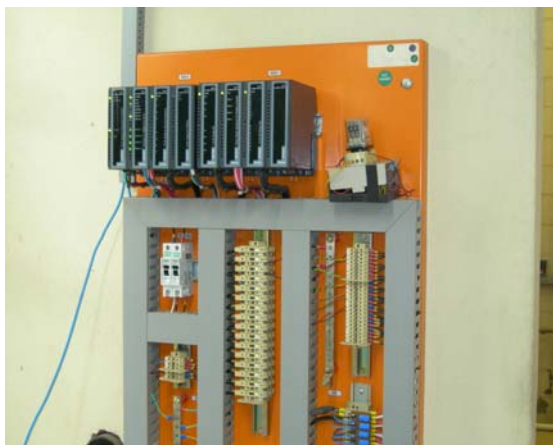
Figura 4.2 – Foto ilustrativa da montagem do sistema em Rede Fieldbus para o processo de precipitação da bromelina
