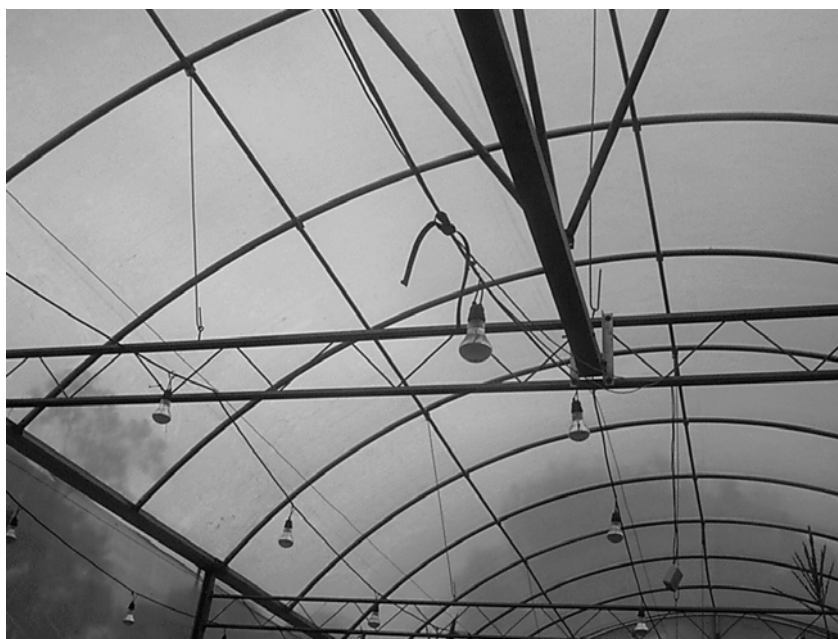
Figura 9 – Conjunto de Iluminação Artificial
