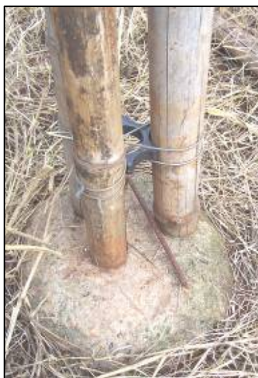
Figura 14. Apoio e fixação das colunas sobre uma sapata de concreto com vergalhão chumbado em formato de “U”.
