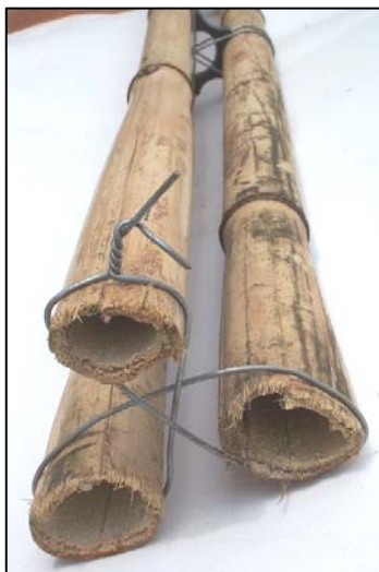
Figura 31. Quebra da coluna por cisalhamento devido à ação de vento de 115,5 km/h.
