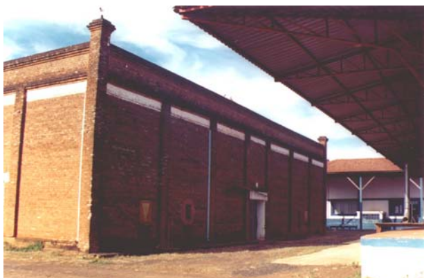
Depósito da indústria Matarazzo, ao lado da tulha. Votuporanga, julho 2002. Foto do autor.
