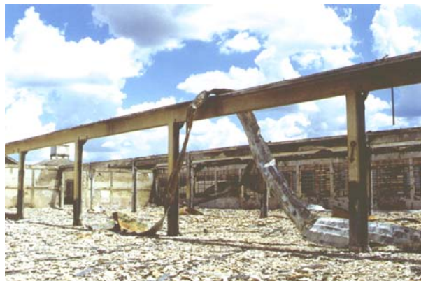
Edifício da preparação da fiação, após o incêndio. Ribeirão Preto, janeiro 2001. Foto do autor.
