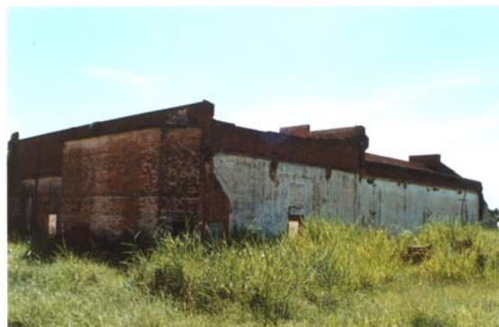
Ruínas de alguns dos edifícios da indústria Matarazzo. Bernardino de Campos, maio 2002. Foto do autor.
