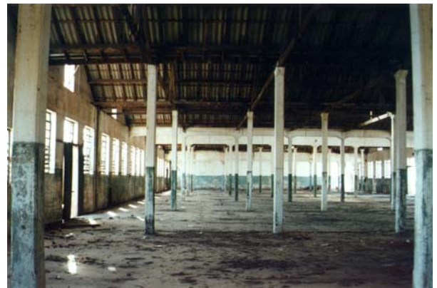
Interior do pavilhão principal da tecelagem Matarazzo. Bauru, julho 2002. Foto do autor.
