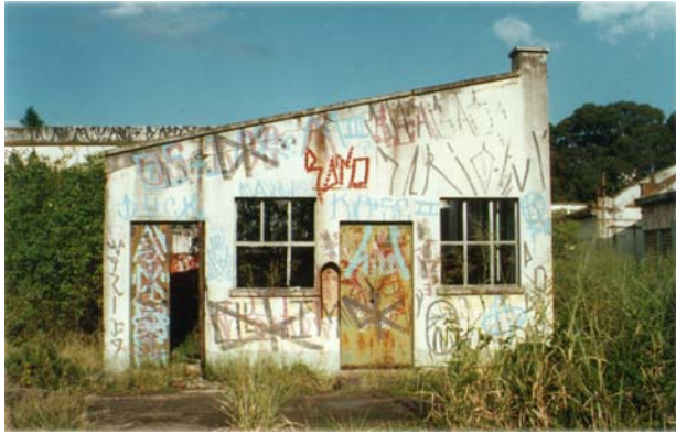
Cabine elétrica da fábrica de óleo Matarazzo. Campinas, abril 2002. Foto do autor.
