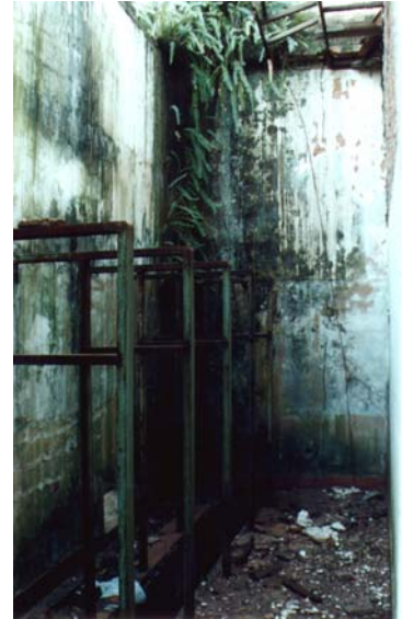
A cabine de força da tecelagem Matarazzo. Bauru, julho 2002. Foto do autor.
