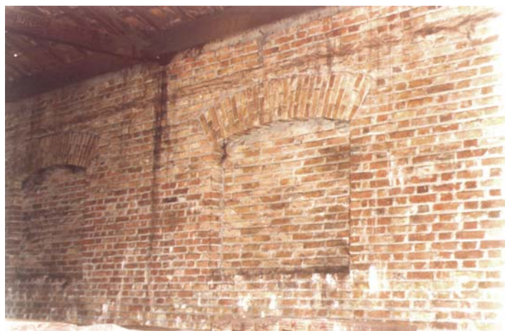
Detalhe da janela, com arco abatido em tijolos, vedada posteriormente. Bauru, novembro de 2003. Foto do autor.
