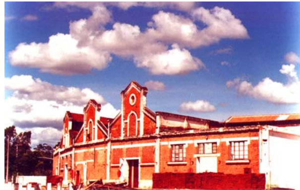
Os galpões da Matarazzo, sendo que o último (à direita) sofreu desabamento de toda a sua cobertura e parte de sua fachada, por causa de uma tempestade. Avaré, novembro de 2003. Foto do autor.
