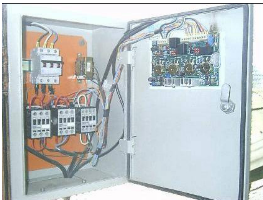
Figura 11 – Quadro de comando automático da bomba e exaustores
