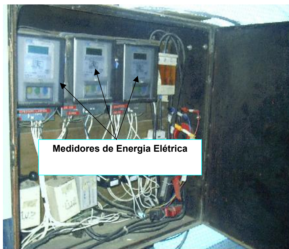
Figura 8 – Medidores SAGA 2300 e transformadores de corrente
