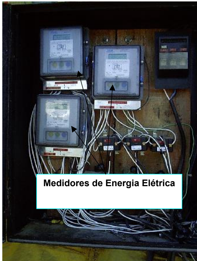
Figura 6 – Quadro dos Medidores de Energia do Galpão 1
