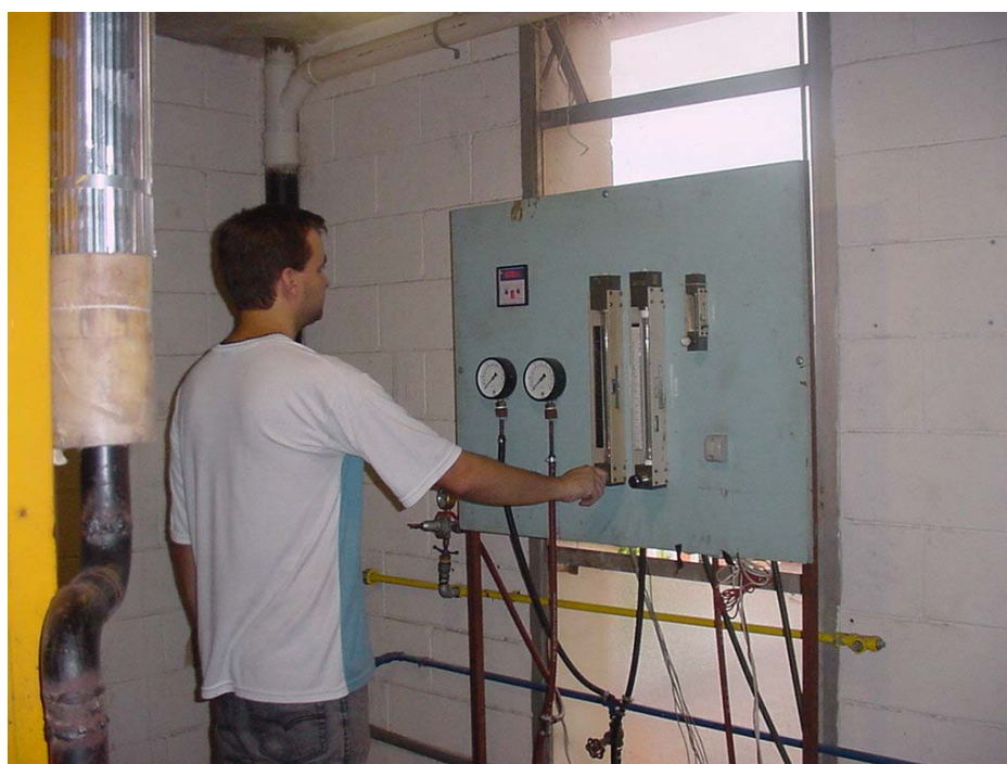
Figura 5. 5: Sistema de Alimentação e Painel de Controle
