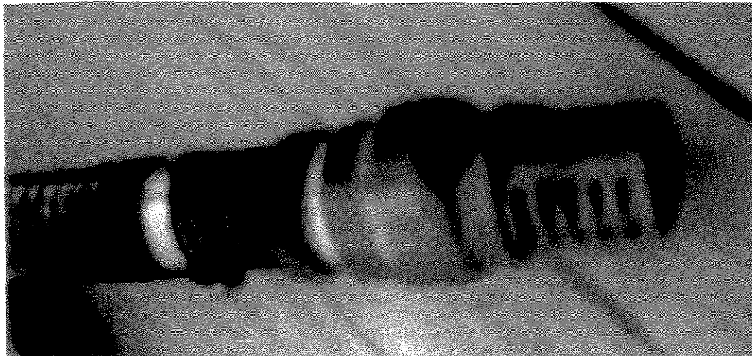
Foto 6.2. Válvula de pé e crivo, na tubulação de sucção da instalação.
