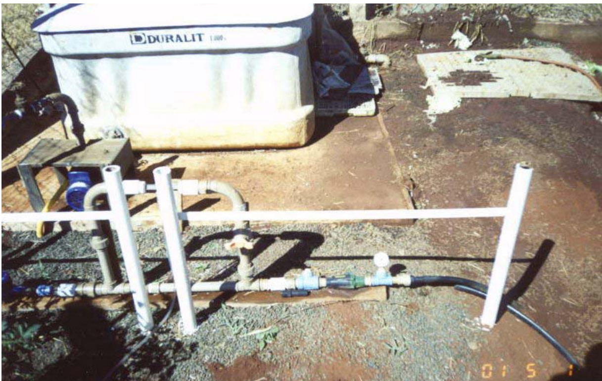
FIGURA 8: Válvula reguladora de pressão (14 mca) e manômetro na saída do cabeçal de controle.
