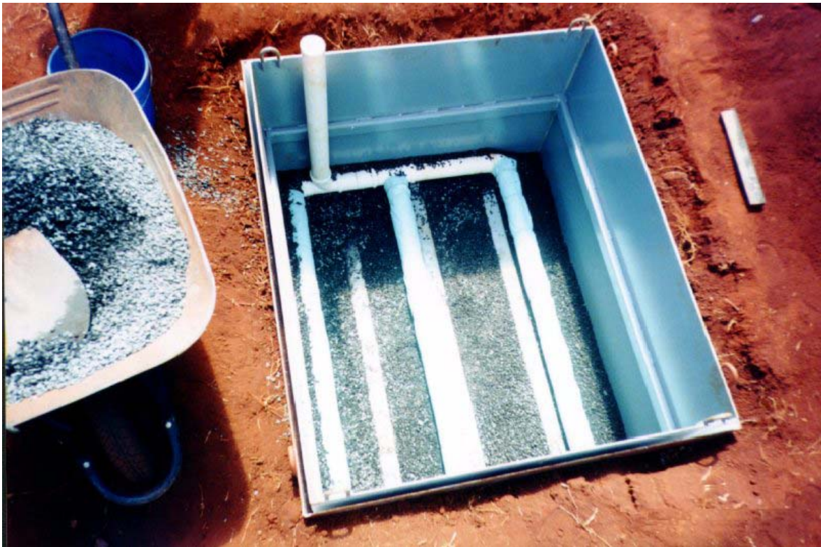
FIGURA 3: Sistema de drenagem instalado no fundo dos tanques internos
