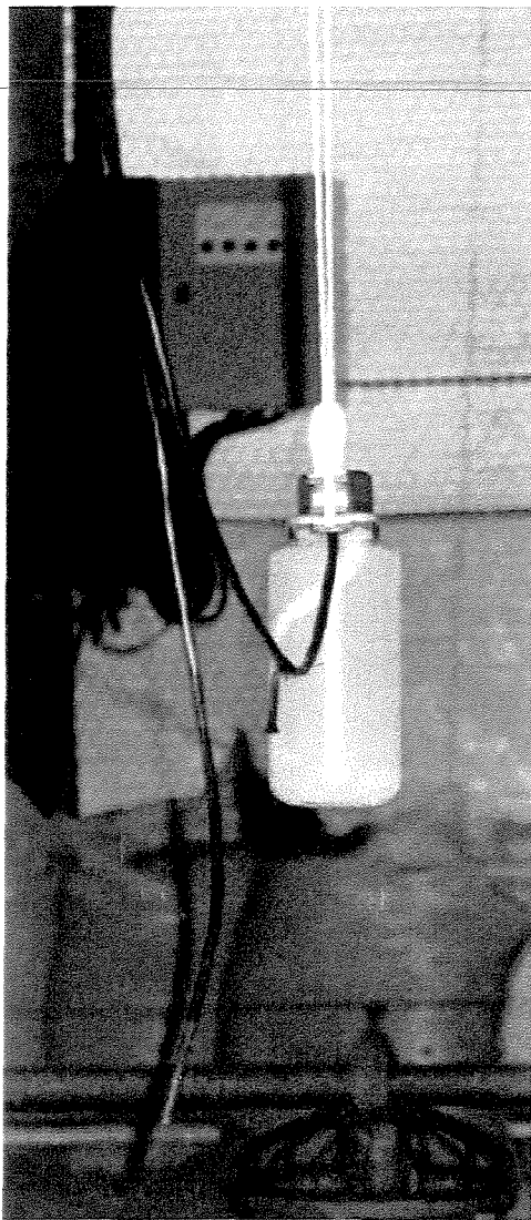
Figura 19. No fundo o controlador Climatic I e os sensores de bulbo seco e bulbo úmido com seu reservatório para água.
