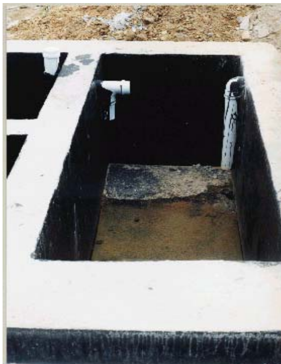
Figura 4. Detalhe da primeira câmara, a tubulação que conduz o resíduo bruto proveniente do tanque de equalização à primeira câmara e a tubulação que conduz o efluente desta para a segunda câmara.
