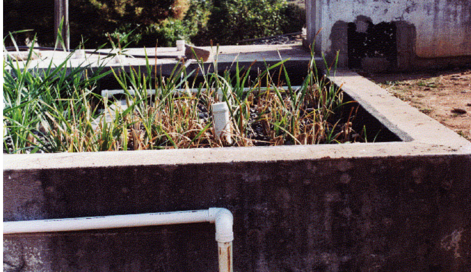
Figura 6. Mostra a tubulação que conduz o efluente do primeiro para o segundo leito de macrófitas, situação das plantas do primeiro leito e ao fundo o reator anaeróbio compartimentado.
