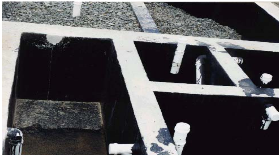
Figura 3. Mostra o interior dos compartimentos e as tubulações de abastecimento do afluente e de escoamento do efluente.
