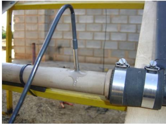
FIGURA 3. Sensores de temperatura do tipo PT-100 inseridos nas tubulações. PT-100 temperature sensors inserted in the pipes.
