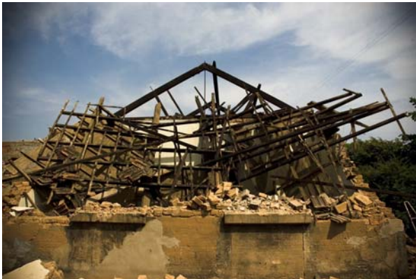
Foto 03: Escombros do madeiramento do telhado.
