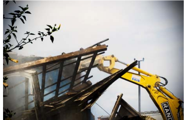
Foto 02: Destruição do madeiramento do telhado.
