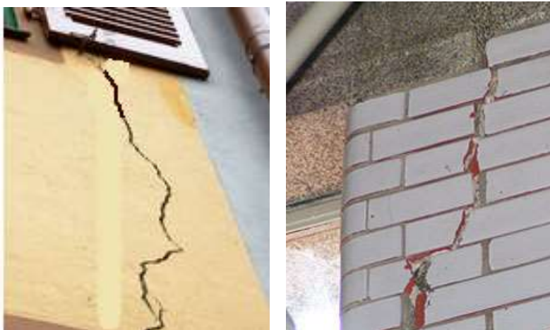
Сл. 4.20 – Вертикалне пукотине услед неравномерног слегања објекта - у Гогољевој улици. Извор: фотографије аутора
