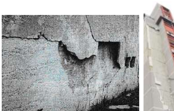
Сл. 5.24 – Пуцање и одвајање малтера са фасадног зида стамбеног објекта на Видиковачком венцу. Извор: фотографија аутора
