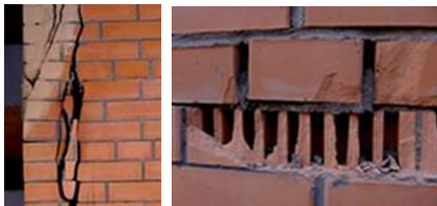
Сл. 5.25 – Лоше дејство воде и мрза на фасадну опеку у улици К. Катарине Извор: фотографија аутора
