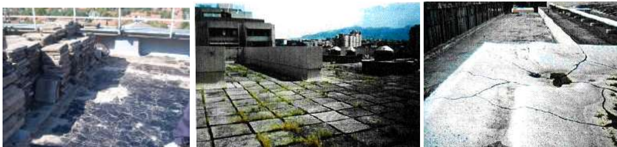
Сл. 4.57 – Примери објеката са оштећеним равним крововима који захтевају санацију. Извор: https://urs-ufa.ru/bs/types-of-roofs-overhaul-of-the-roof-of-the-apartment-building.html
