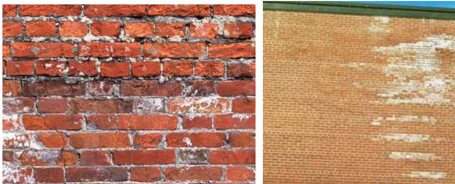
Сл. 4.18 – Исцветавање соли на површини фасадног зида – у улици Видиковачки венац Извор:фотографије аутора
