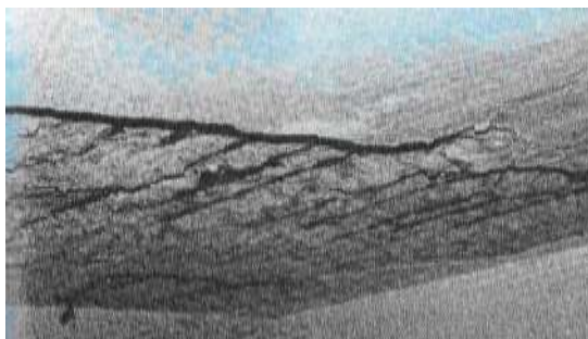
Сл. 4.35 – Знатно оштећена доња површина АБ плоче. Извор: http://www.gradjevinarstvo.rs
