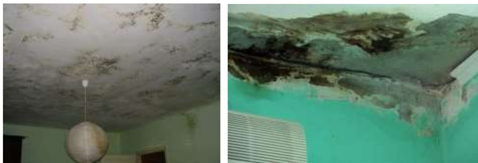
Сл. 4.56 - Последице неадекватне израде равног крова. Извор: http://www.gradjevinarstvo.rs
