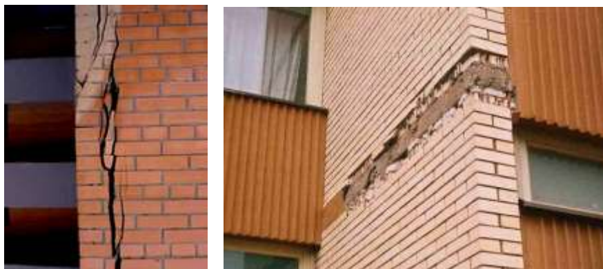
Сл. 4.19 – Оштћења фасадног зида услед дејства мраза – у улици Видиковачки венац Извор:фотографије аутора
