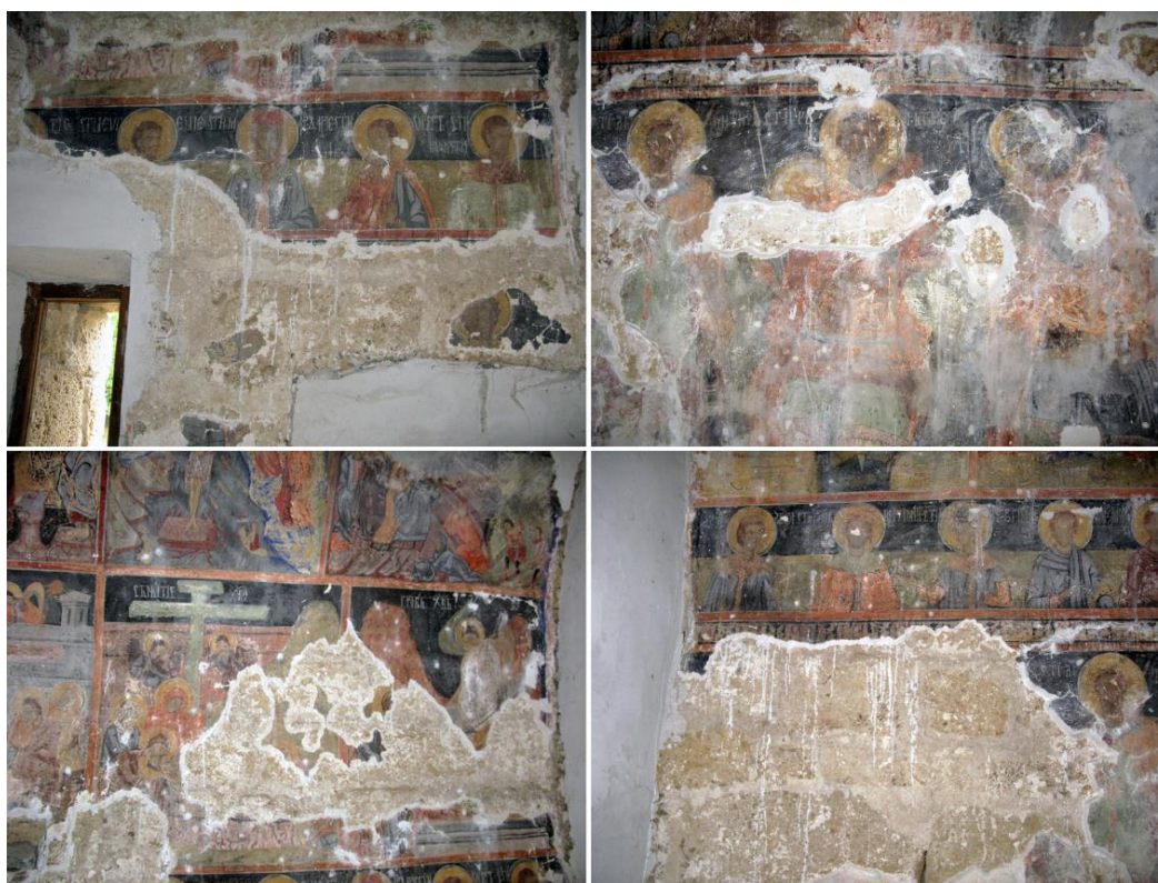
Slika 42. Ekstenzivna oštećenja zidnih slika naosa crkve sa naglašenim gubitkom bojenog sloja i malterne podloge na velikim površinama
