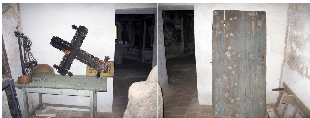
Slika 39. Potklobučenja i obrušavanje maltera severnog i južnog zida priprate
