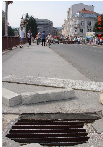
Slika A.2.8. Oštećenje pešačke staze
