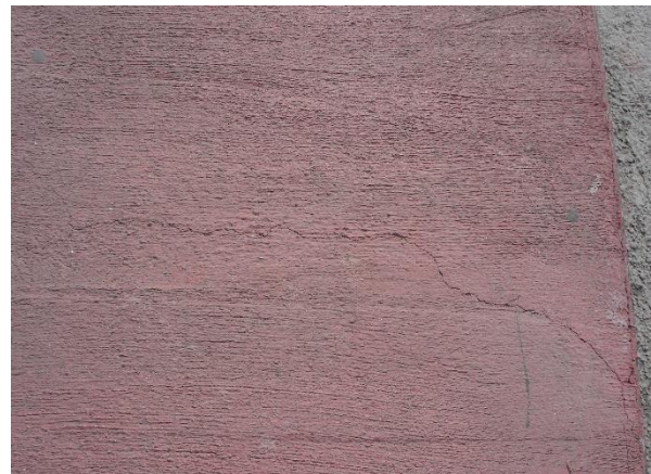
Slika A.2.13. Prsline na pešačkoj stazi
