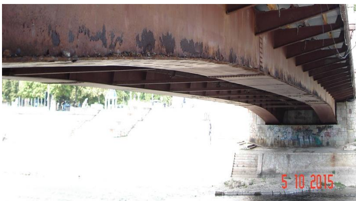
Slika A.2.14. Korozija glavnog nosača
