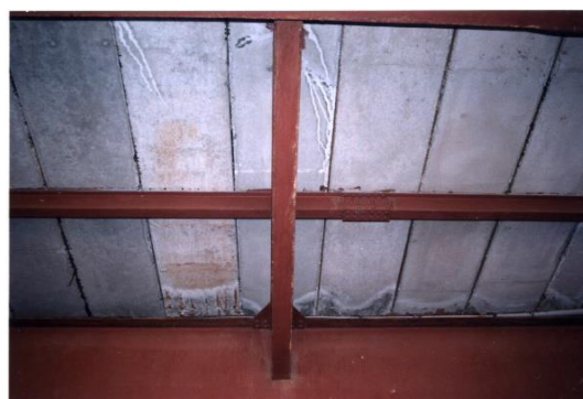
Slika A.2.4. Oštećenja montažnih betonskih talpi
