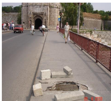
Slika A.2.10. Oštećena pešačka staza
