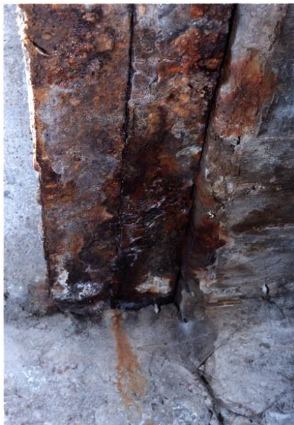
Slika A.2.7. Korozija čelika na spoju
