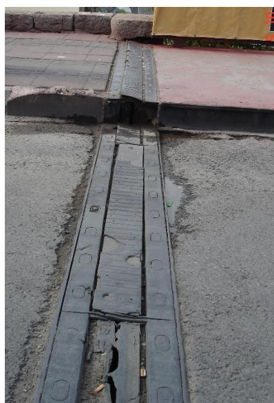
Slika A.2.6. Oštećenja dilatacije
