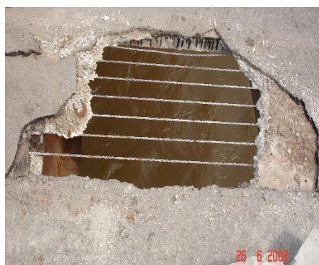
Slika A.2.9. Detalj oštećenja
