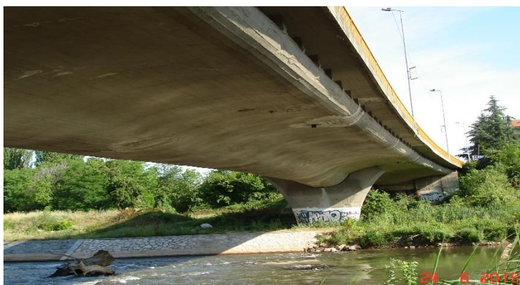
Slika A.5.6. Oštećenje glavnog nosača
