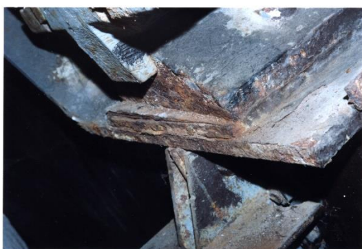
Slika A.2.3. Korodirali čelični nosači
