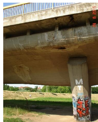
Slika A.5.7. Detalj oštećenja
