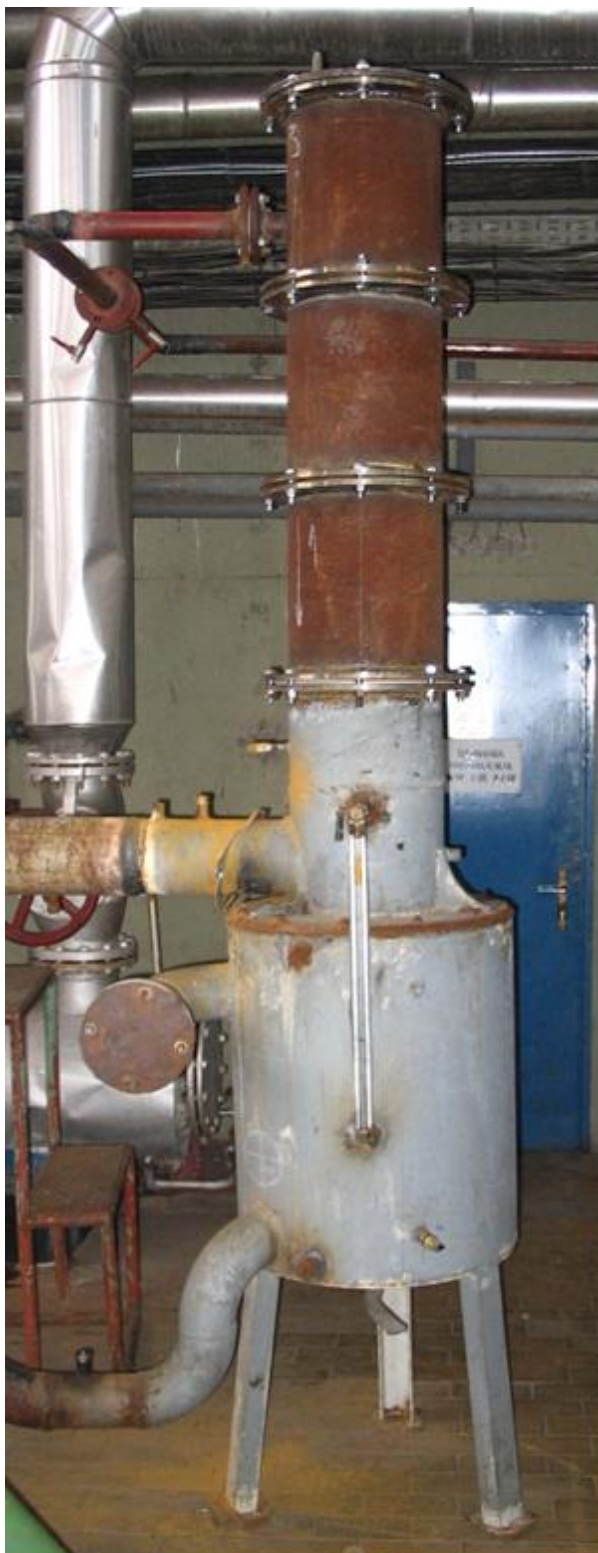
Слика 4.3 Фотографија дегазационе колоне
