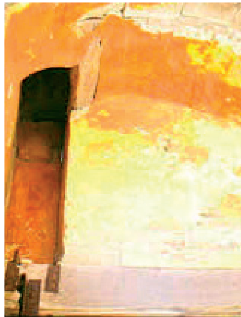
Slika 9. Patina „sciabaltura“ na stubovima i fasadi istorijske građevine
