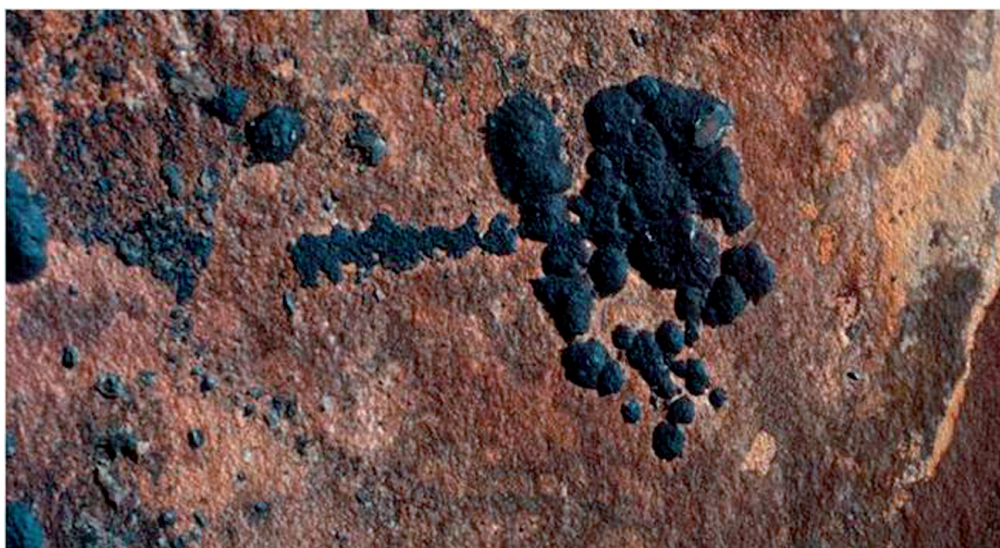
Slika 4. Crne kvržice mikrokolonijalnih gljiva (MCF) na površini kamenog supstrata kulturnih dobara
